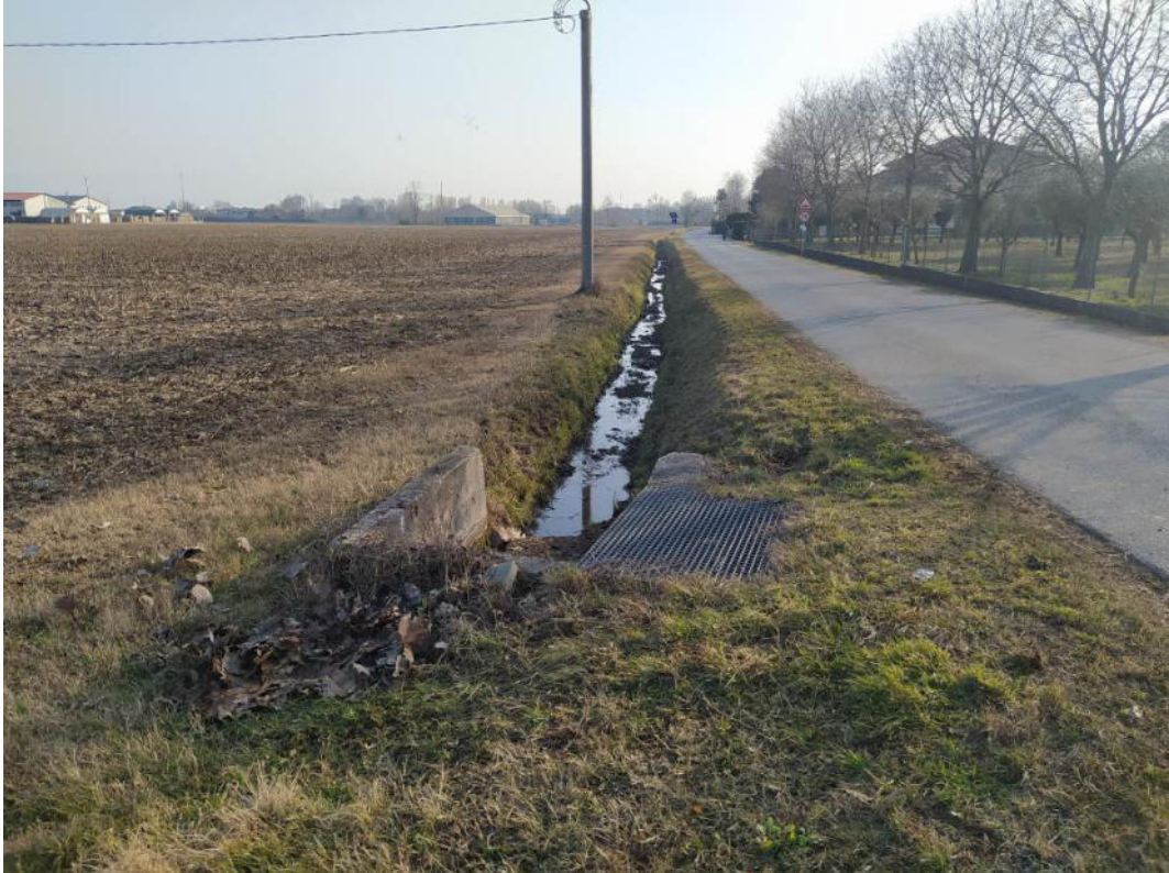
Foto 4 - via Serraglio: sifone del manufatto partitore e scarico “Terre Grosse - ramo 1”
